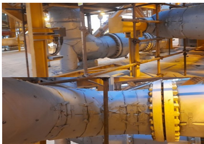
شکل ۲. پوشش آکوستیکی پتویی در خطوط لوله متصل به توربواکسپندر.
